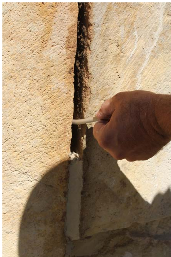
სამხრეთი კედელი, ფასადი, ქვის გახსნილი ნაკერის ამოვსების პროცესში აუცილებელი გახდა ქვებს შორის, ზედაპირიდან 5-7 სმ.-ის სიღრმეზე ინექტირების გაკეთება.
