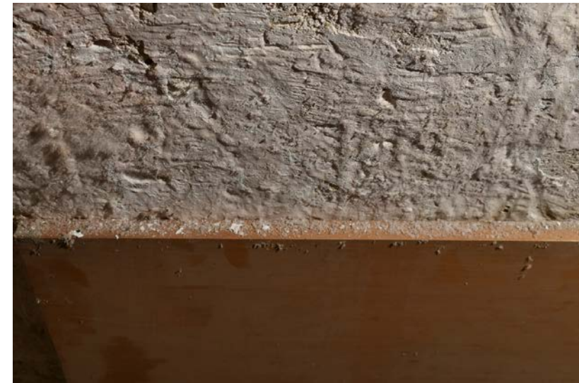
ეკლესიის ინტერიერი: ჩრდილოეთ კედლის დასავლეთ ნაწილში, კედელზე მიყუდებულ ფიცარზე ნათლად ჩანს კედლიდან ჩამოცვენილი მარილის ნაწილაკები.
