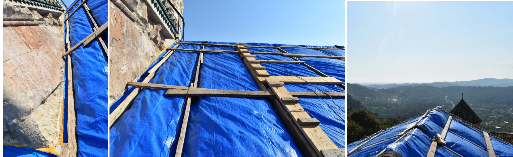
დასავლეთი მკლავის ჩრდილოეთი ფერდი. ტრომპის კედელთან შეპირაპირების ადგილი დაფარულია/ ამოვსებულია საიზოლაციო ქაფით (1). ტენტი ჩამაგრებულია ხის ფიცრებით (2) ტენტი გადასულია ორივე ფერდზე (3).
