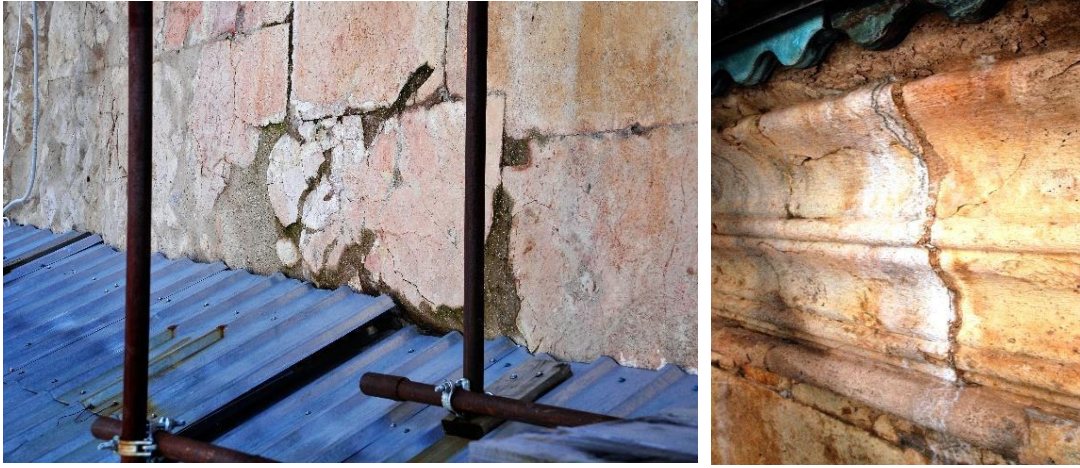
სურ. 51, 52. ჩრდილოეთი ფასადის მდგომარეობა ჩრდილოეთ მკლავთან ახლოს - ბოლოდროინდელი ტენიანობა შემავსებელ დულაბზე და მარილების კრისტალიზაცია
