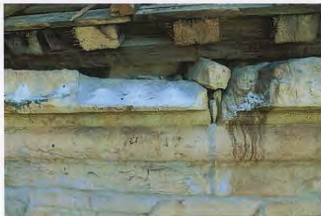
ზემოთ, მარჯვნივ: ჩრდილოეთ ფასადი, კარნიზი, საერთო ხედი ზემოთ, მარცხნივ: დაზიანებული კარნიზის ქვა, დეტალი ქვემოთ, მარცხნივ: დაზიანებული კარნიზის ქვა, დეტალი
