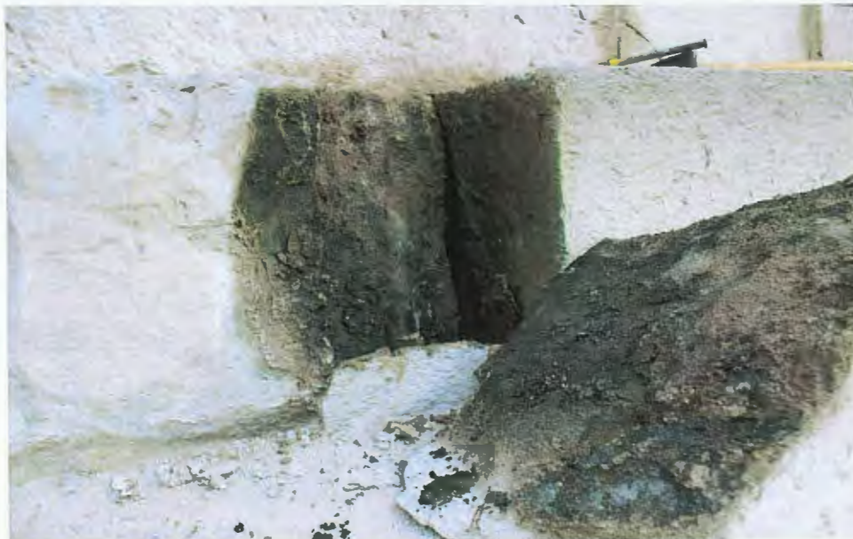
ზემოთ: ფოტო. ცოკოლის ქვის დაზიანებული დეტალი, დემონტაჟის შემდეგ. აღენიშნება ბიოლოგიური დაზიანება. დეტალი შესაბამისად დამუშავდა დამონტაჟდა ავთენტიკურ ადიგლას.
