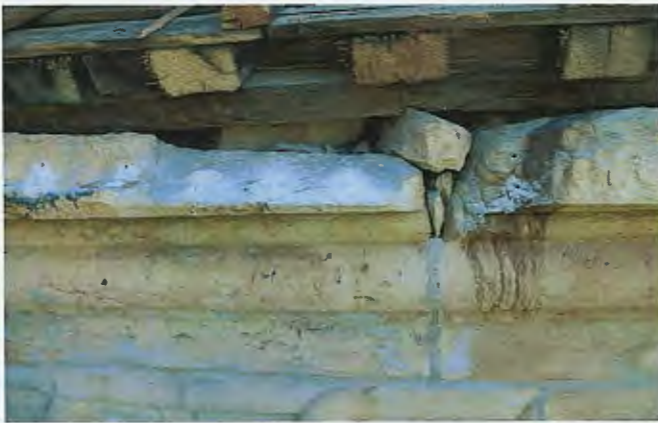
ზემოთ, მარჯვნივ: ჩრდილოეთ ფასადი, კარნიზი. საერთო ხედი ზემოთ, მარცხნივ: დაზიანებული კარნიზის ქვა, დეტალი ქვემოთ, მარცხნივ: დაზიანებული კარნიზის ქვა, დეტალი
