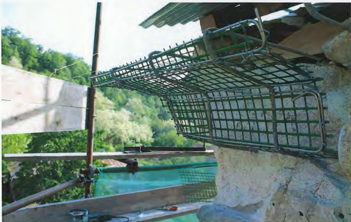
ზემოთ: ფოტო. სამხრეთ ფასადი, კარნიზი. წინასწარ მომზადებულ საანკერე ხვრელებში, უჟანგავი ლითონის 8მმ-იანი არმირებისთვის განკუთვნილი კარკასის მონტაჟის პროცესი.
