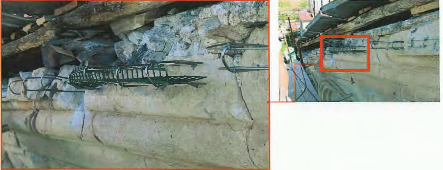
მარცხნივ/ზემოთ ფოტო ნმმ სისქის უჟანგავი ლითონითა და მინაბოჭკოვანი საარმირებო ზადით არმირებული კარნიზის ქვა-დეტალი მარჯვნივ/ზემოთ ფოტო. ჩრდილოეთ ფასადი.კარნიზი.კონტექსტი.
