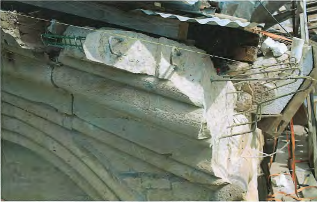
ზემოთ ფოტო. სამხრეთ ფასადი, კარნიზი, საანკერე ხვრელებში 8მმ-იანი უჟანგავი ლითონის ანკერების მთავსების პროცესი.
