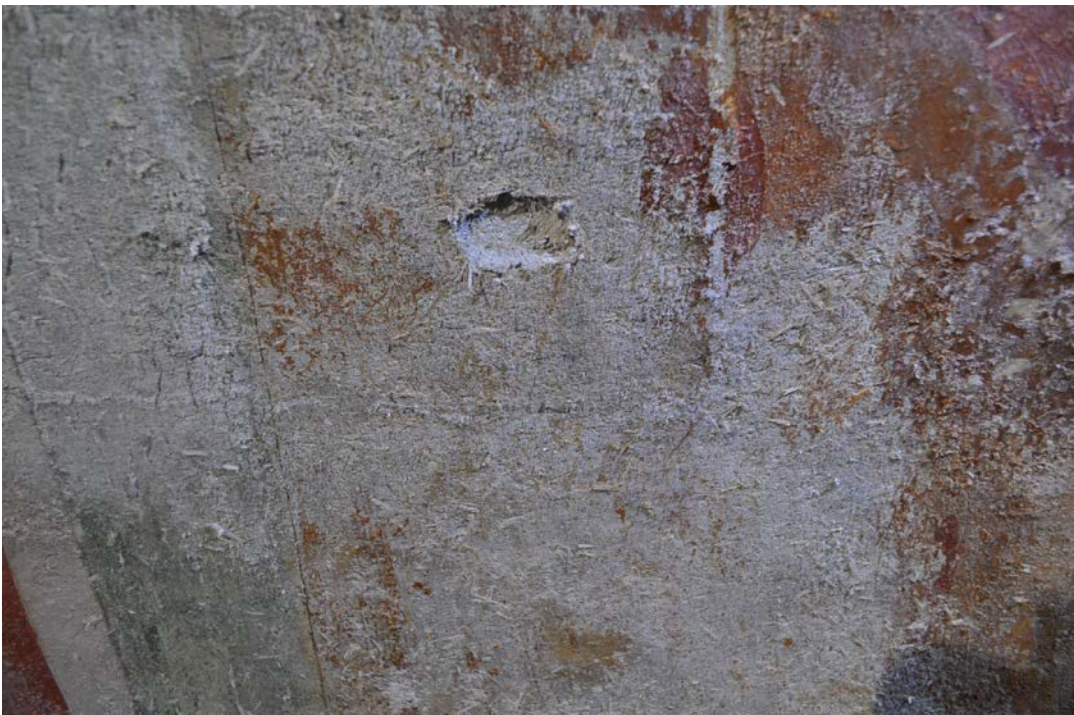
15. დასავლეთი მკლავის კამარის სამხრეთი ფერდი, მდგომარეობა სრული კონსერვაციის შემდგომ. ნალესობის გაფხვიერება, ამოტეხვა
